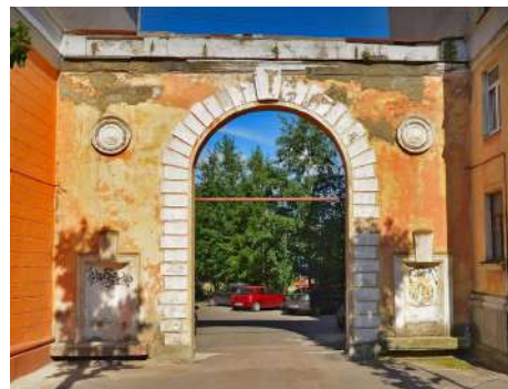
Рисунок 5.1.72 – Пример замкового камня над аркой между домами № 27 и 29 по пр-кту Ленина
