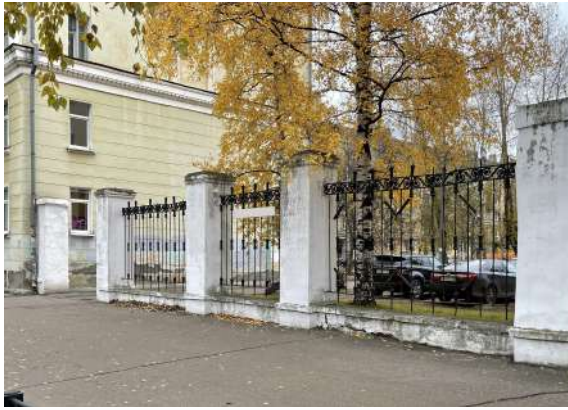
Рисунок 5.2.2.3 – Примеры высокого декоративного ограждения из визуально проницаемого ограждения в сочетании с пилонами между домами № 10 и 12 по пр-кту Ленина
